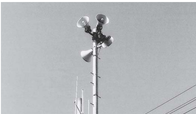
市内121ヶ所に設置されている屋外子局
